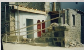
Destruction de la sacristie
